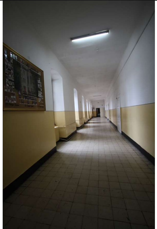
TRONSON C? – ETAJ 2, CORIDOR, PLANSEU BETON
