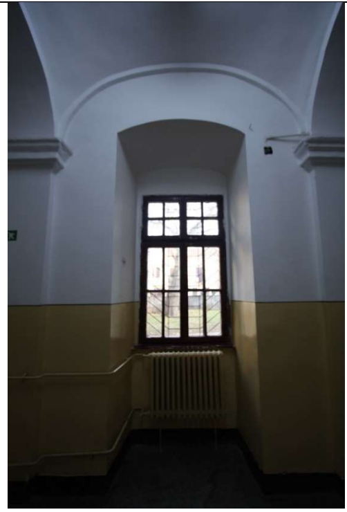
TRONSON A – PARTER, CORIDOR, BOLTA CILINDRICA, CU ARCE DUBLOURI SPRIJINITE PE PILASTRII CU CAPITEL
